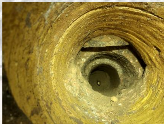
Conduite hydraulique du Bassin haut, 25.7.20 - Cliché Sylvain Chaumier
